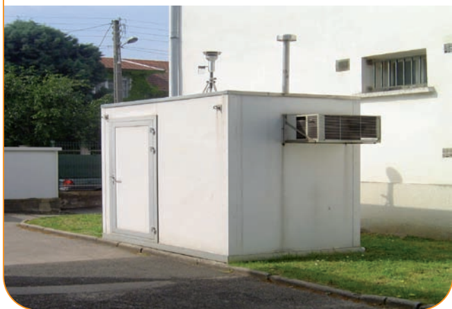
Station de mesure
